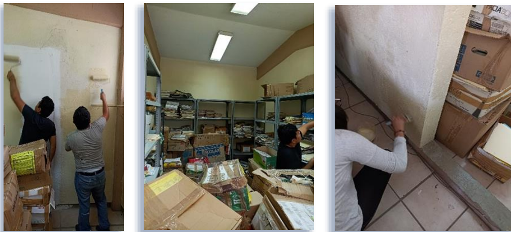
Pintado de la cerca metálica, colindante a barda perimetral paralela a calle Tecnológico, de color blanco.
